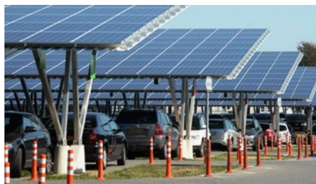
図 4 駐車場の太陽光発電設置の様子 22
