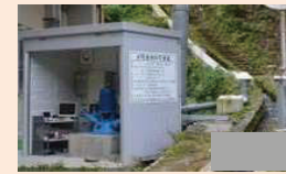
小水力発電設備
