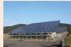
太陽光発電設備
