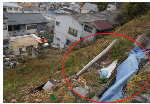
当該土地は高台に位置しており、強風・豪雨等の 際には、瓦礫や柵等の落下が懸念されており、 低地の住民にとっては非常に危険な状況
