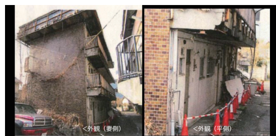
外壁、手すりが崩落した事例
