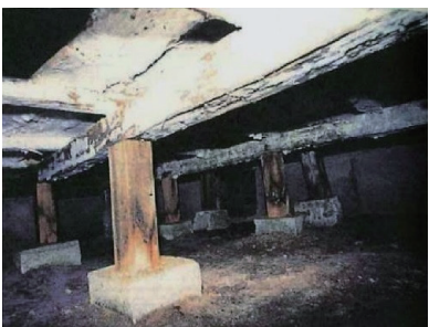
床下の木材の腐朽
