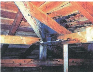
小屋組の漏水跡
