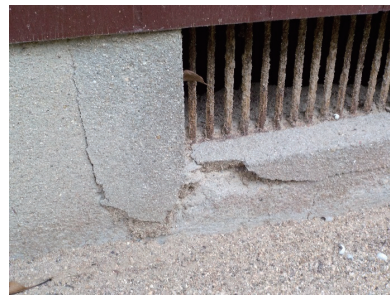
基礎立ち上がりの割れ
