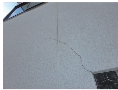
外壁のひび割れ
