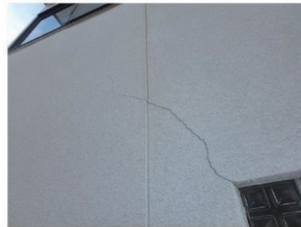
外壁のひび割れ
