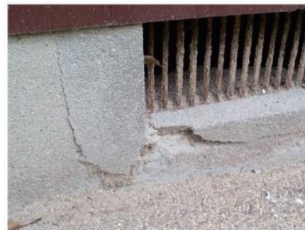
基礎立ち上がりの割れ
