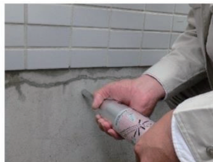
リバウンドハンマーを用いたコンクリートの 圧縮強度の測定
