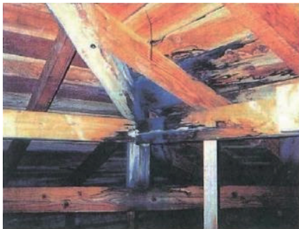
小屋組の漏水跡
